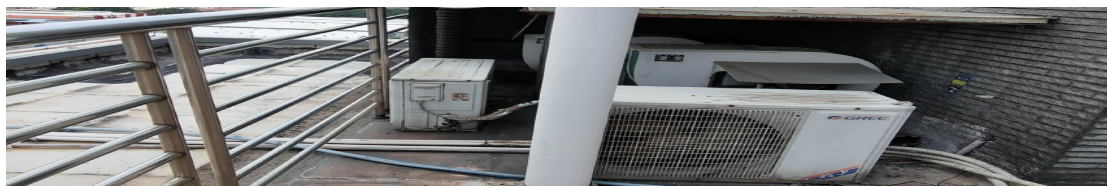
附件 2: B 座 6 楼希悦尔公司室内外渗漏点现场图片
